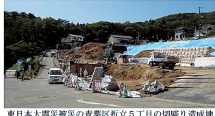
東日本大震災被災の青葉区折立5丁目の切盛り造成地
