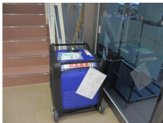
センター1階正面玄関に設置
