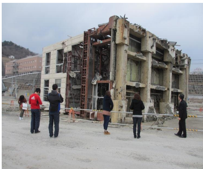
女川の3階建の建物が倒壊した場所にて
